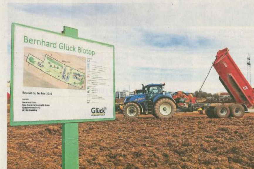
Mit schwerem Gerät wird in der Klostermeiergrube auf drei Hektar Fläche ein Biotop geschaffen.
