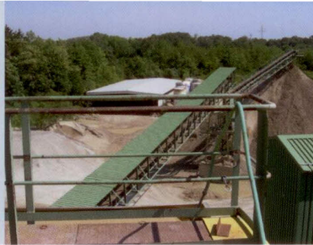
Verhaltung über Förderband
